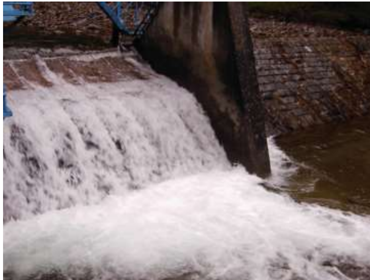
Речно водохващане „Бента“ на река Черни Осъм
